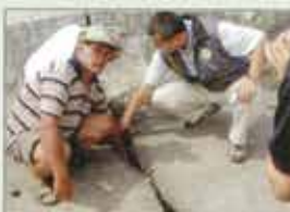
2008年 會勘因颱風造成大城 西港橋裂縫
